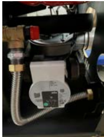
Sicherheitsventil und Ladepumpe
