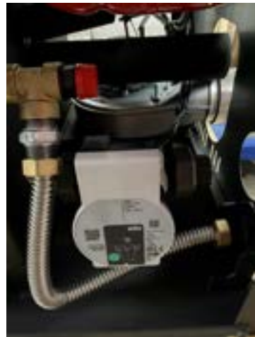
Sicherheitsventil und Ladepumpe
